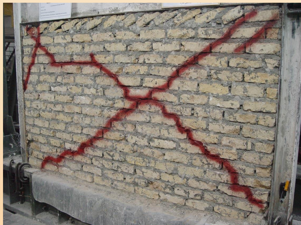
مسیر ترک ها در زیر رویه سیمانکاری
