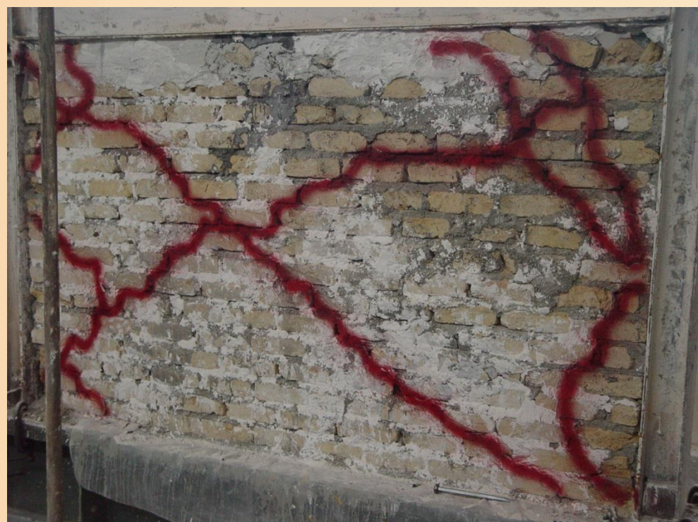
مسیر ترک ها در زیر رویه گچ کاری
